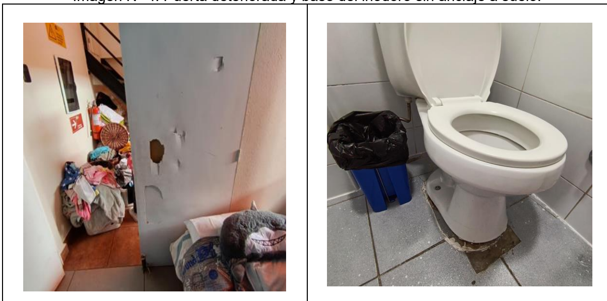
Imagen N° 4: Puerta deteriorada y base del inodoro sin anclaje a suelo.
