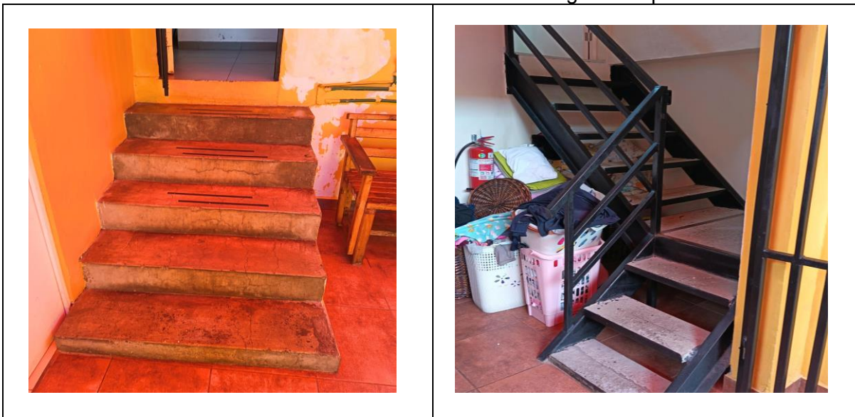
Imagen N° 9: Escalera de salida al patio con revestimiento antideslizante desgastado y escalera de acceso a las oficinas con aristas agudas expuestas.
